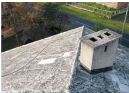
Rys. 1. Widok dachu kopertowego, czterospadaowego pokrytego uszkodzonymi płytami cementowo-azbestowymi
